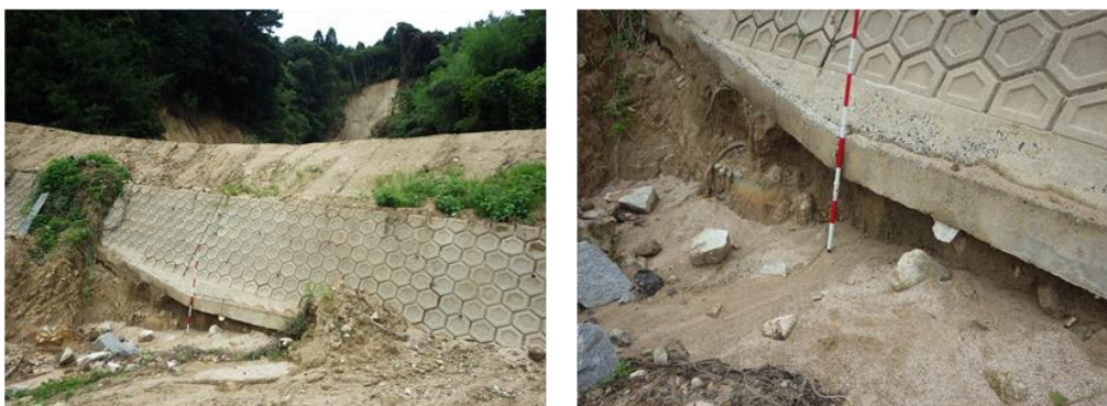
図 5.2.11 土石流による道路擁壁基部の洗掘状況【ポイント番号⑩】
