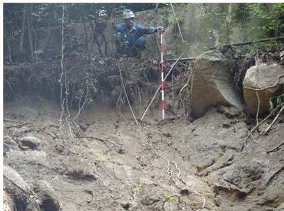
(a) 源頭部（作業道直下：標高 433 m）の崩壊
