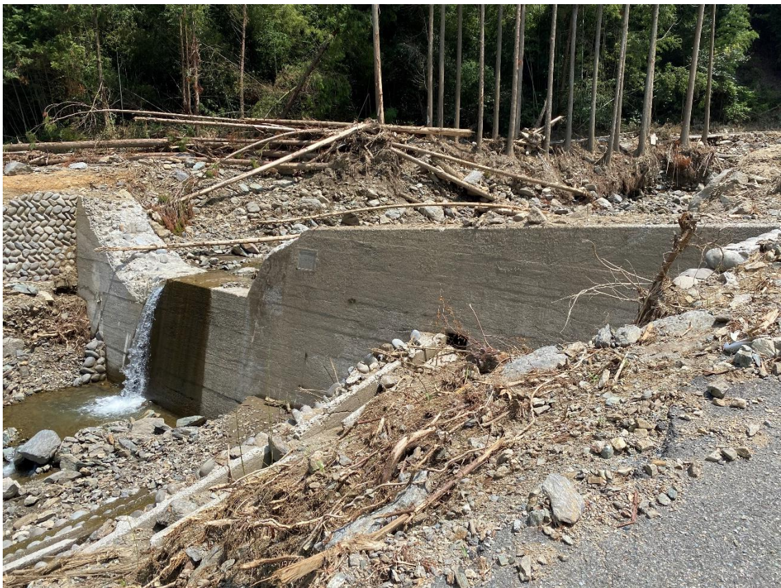
図 4.2.4 東大光砂防堰堤の被災状況（令和 5 年 7 月 29 日撮影）
