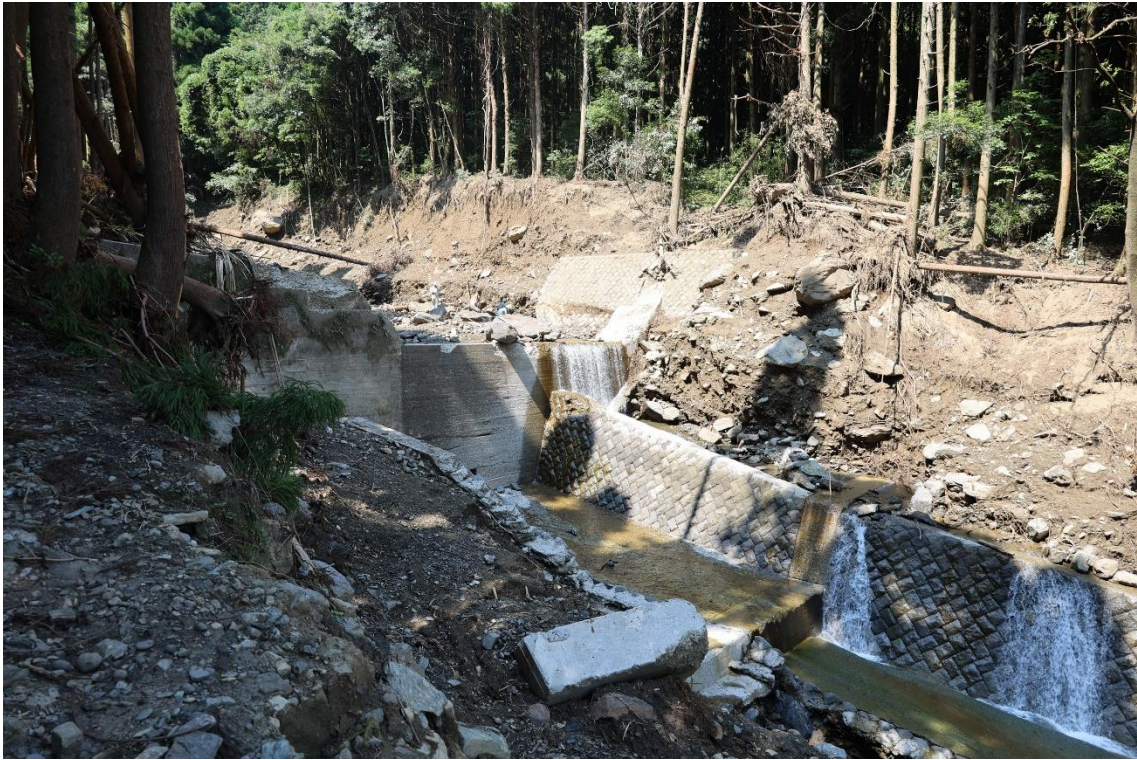
図 4.2.3 堂所砂防堰堤の被災状況（令和 5 年 7 月 29 日撮影）
