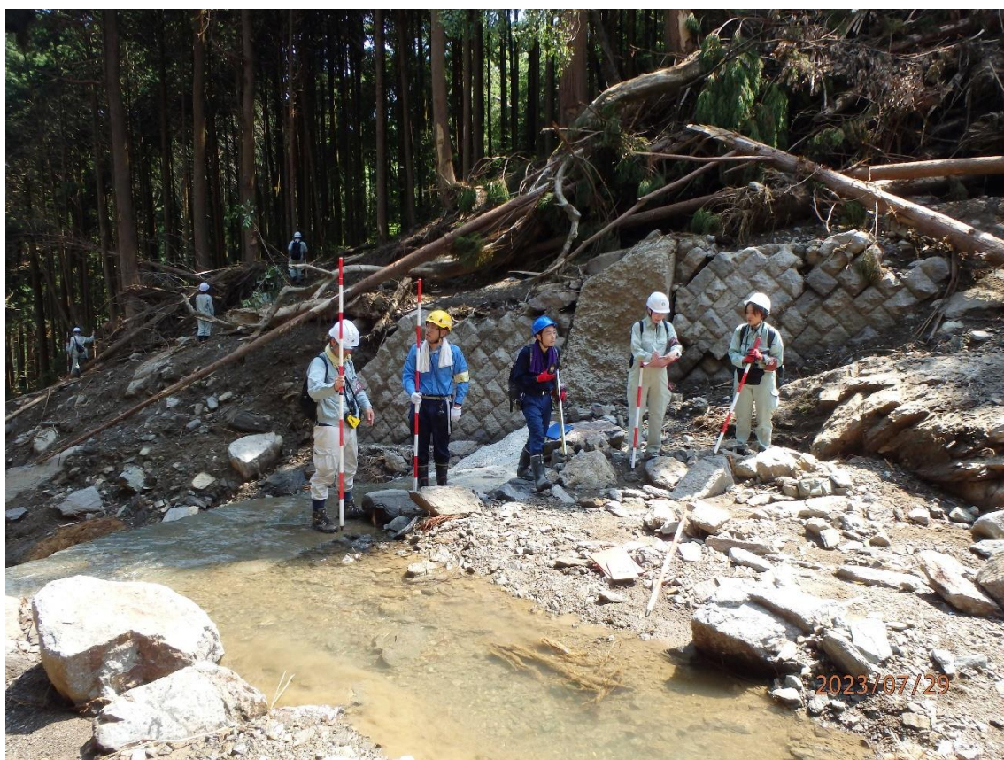
図 4.2.2 笹尾砂防堰堤の被災状況（令和 5 年 7 月 29 日撮影）
