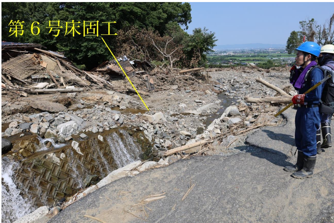
図 4.2.9 第6号床固工とその下流側の溪流保全工 (令和5年7月29日撮影)
