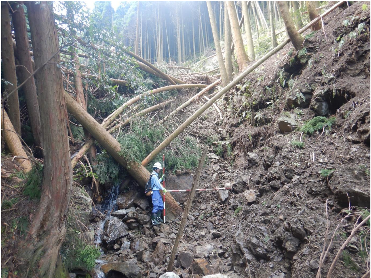
図 3.3.2.2 小規模な河道閉塞箇所の前景（2023年7月29日撮影）
