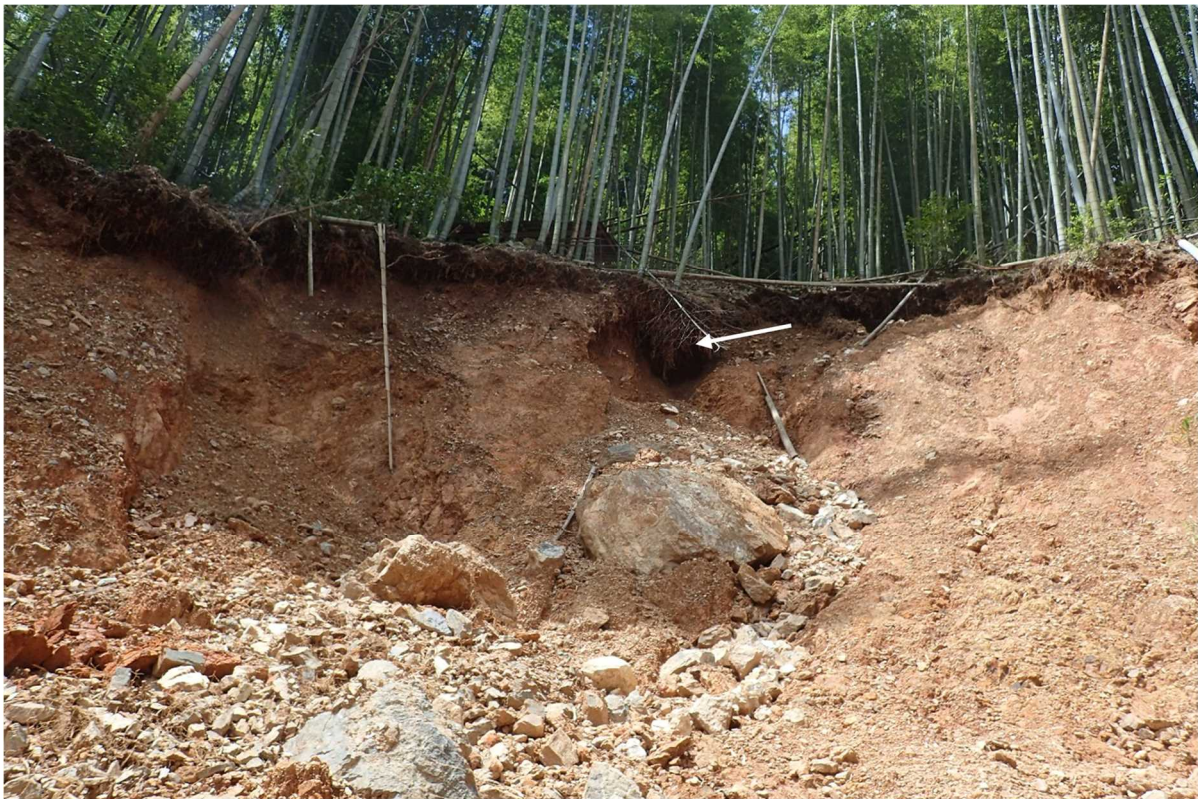
写真 3.3.3 基盤岩 (数 m の硬質ブロックと抜け落ちによる空洞 (矢印), 強風化の厚さは 5m 以上)
