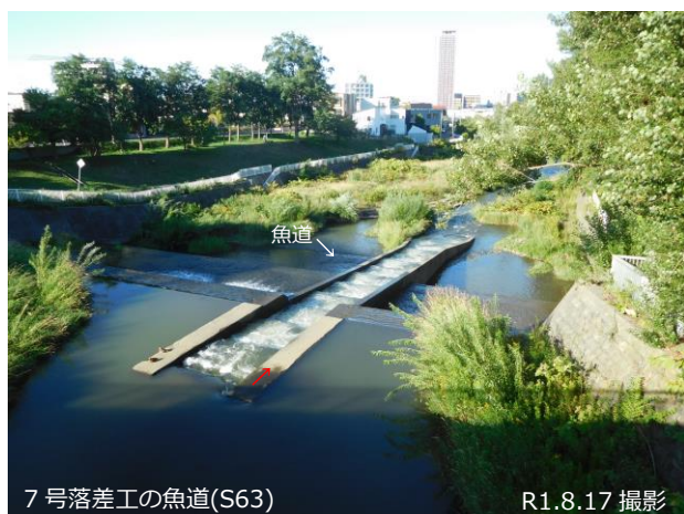
図 40 整備された魚道
