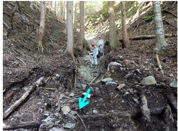
写真④ 溪床堆積土砂の流出状況
