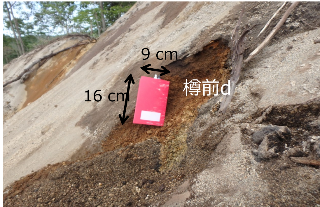
▲樽前dが露出している箇所
