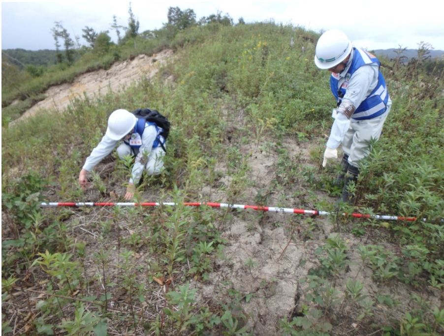
▲崩壊地の上端部のひび割れ
