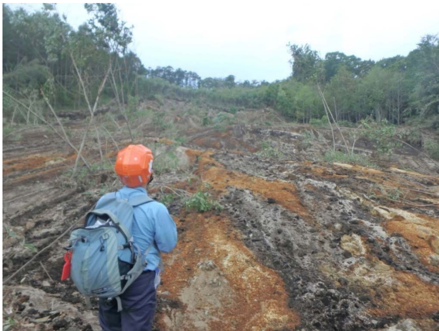
写真－1 桜丘地区の表層崩壊
