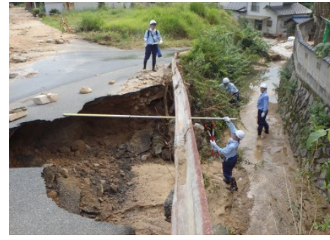
施設被災状況の調査
