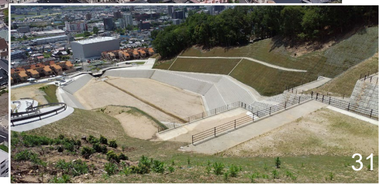
土石流堆積工 堆積工長:約120m 堆積工幅:約60m 貯められる土砂の量: 約20,000m 3
