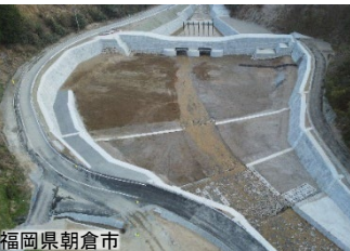
福岡県朝倉市 土砂や流木を効果的に捕捉できる施設整備
