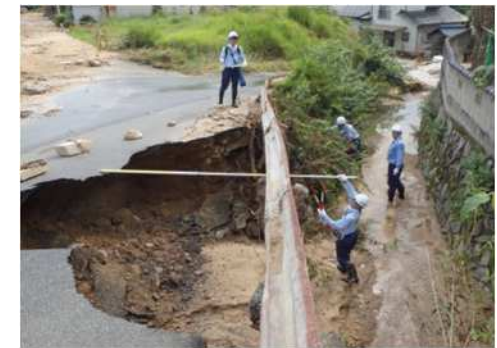
施設被災状況の調査
