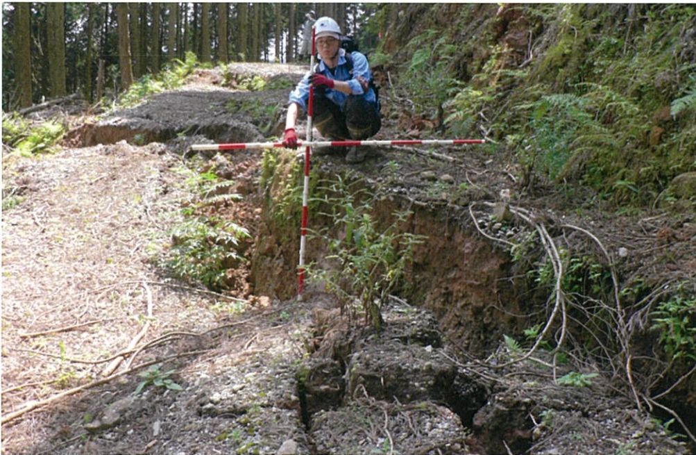
図－4.7 滑落崖の上部面に生じた亀裂
