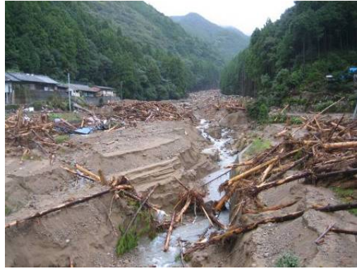
写真-5 本川水位の影響を受けたと想定される土石流の停止・堆積場の状況
