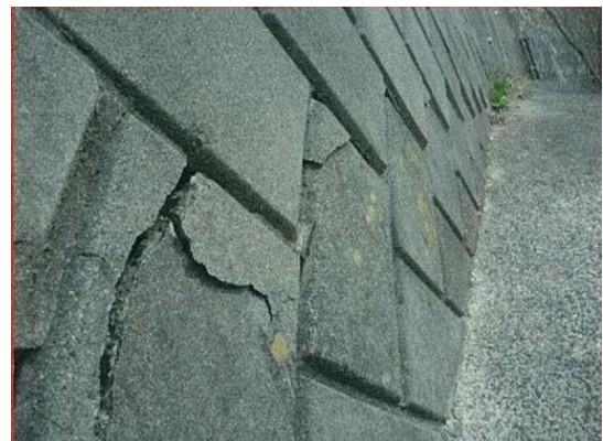
写真－4. 6 福島県大町地区の被害状況 ブロック擁壁に生じたクラック
