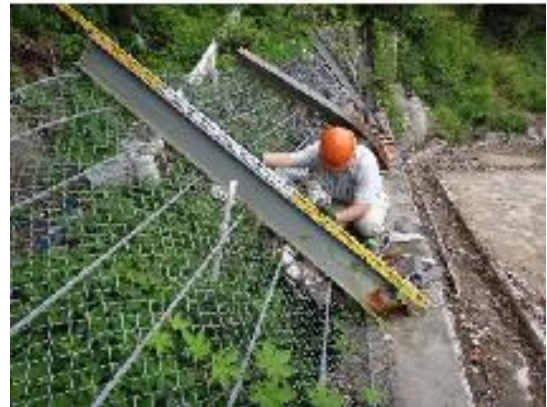
写真－4. 2 岩手県湊地区被害状況 津波による落石防護策の被害
