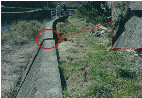
写真－4. 3 福島県原瀬川の被害状況 護岸工継目でズレが生じている
