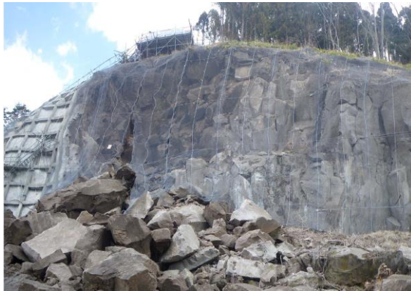
写真－4. 1 宮城県黒崎地区被害状況 遷急線下部の岩盤斜面の崩落
