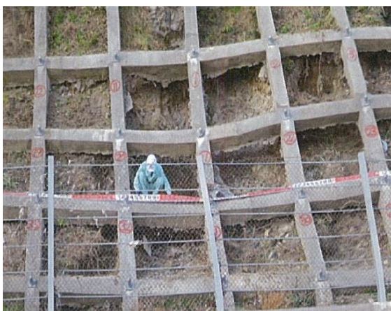
写真－4. 5 宮城県東田地区の被害状況 法枠工の背面の地盤がズれている
