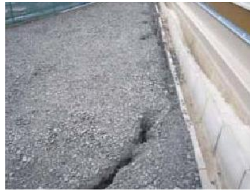
写真－4. 4 茨城県宮町地区の被害状況 斜面上部の地盤に発生したクラック
