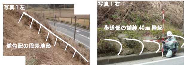
写真-2.3.3 現地で確認した末端部の主な変状
