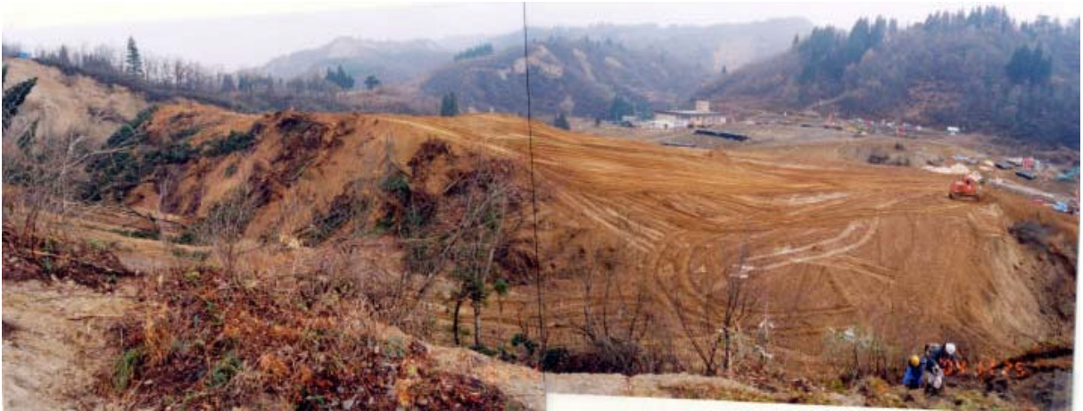
写真 3 末端部での水路掘削による二次すべりの危険性に対する緊急対応として地すべり土塊の頭部で排土工が施工された。 (2004年11月25日撮影)
