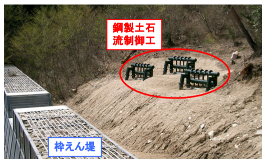
写真1 設置事例 (六甲・奥池)
