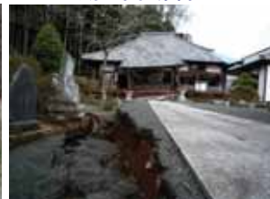
段差による建物の損傷
