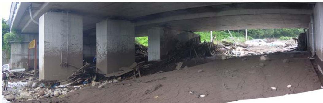
写真5 志平沢川土石流の流下痕跡
