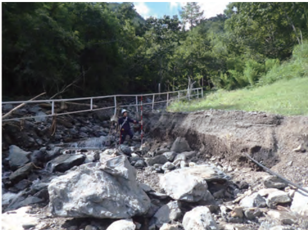
写真-11 取水施設下流の状況。著しく侵食された溪岸・斜面（左岸側）
