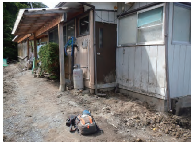
写真-9 崩壊地下の保全対象人家
