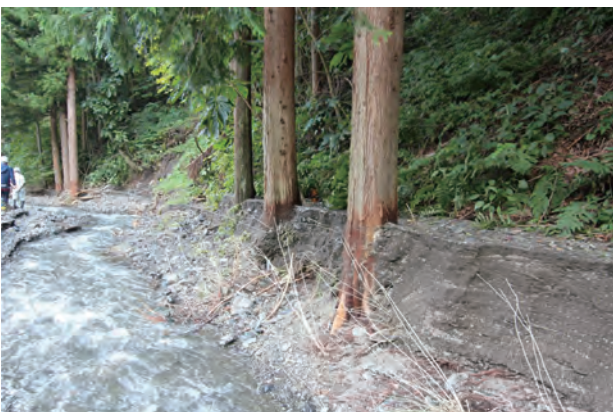
写真-15 土砂埋積後の再侵食によって樹幹の一部が露出したスギ(2016年9月9日撮影) 樹幹に大きな損壊がないことから衝撃力の強い土石流は発生していないと考えられる。
