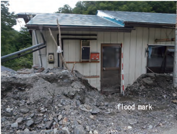
写真-17 地点a (旧国道付近) における土砂と建物の状況
