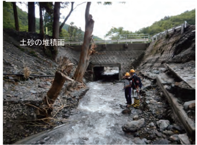
写真-19 国道106号線より上流(地点c)における土砂の堆積状況とボックスカルバート(浚渫後) 河床付近の樹木から左手の高さまで土砂の堆積が生じていたものと推定される。
