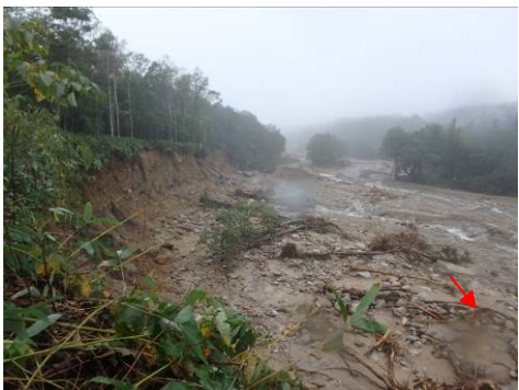
写真5 1号砂防ダム右岸上流の側岸侵食
