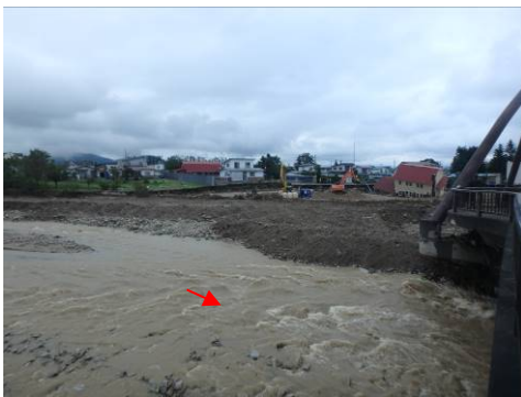
写真12 石山橋上流での左岸側の側岸侵食
