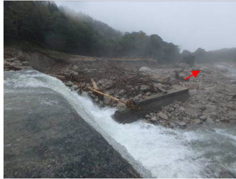
写真4 1号砂防ダム下流の礫・流木の堆積 左岸袖部の欠損, 魚道の埋塞 左岸下流部の側岸侵食とその上部の流木堆積
