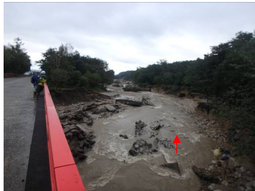
写真9 溪流保全工下流の側岸侵食
