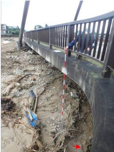
写真10 石山橋での土砂・流木の堆積状況
